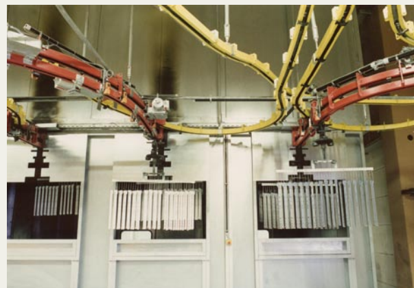
Power+Free-Anlage mit Mehrfachkettenkreisen. Vor der Trockner-einfahrt werden die Laufwerke an einen gesonderten Kettenkreis für die Trocknerfahrt übergeben.
