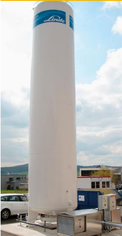
In diesem Tank wird das CO 2 bei dem Automobilzulieferer gelagert
