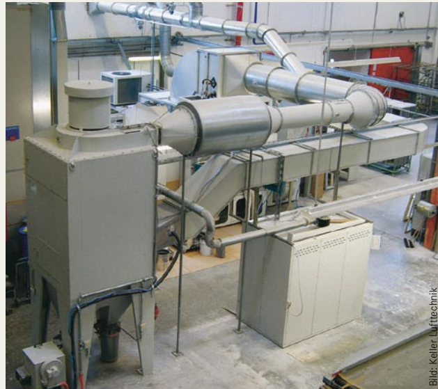
Die Filterelemente der Trockenfilteranlage werden automatisch mit Druckluftimpulsen gereinigt
