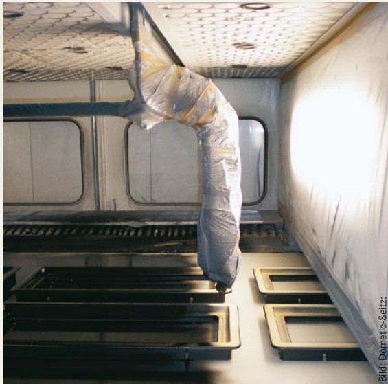
Overspray wird bei der Lackierung der Fensterrahmen mit Hilfe des Transportbandes auf kürzestem Wege zurückgewonnen
